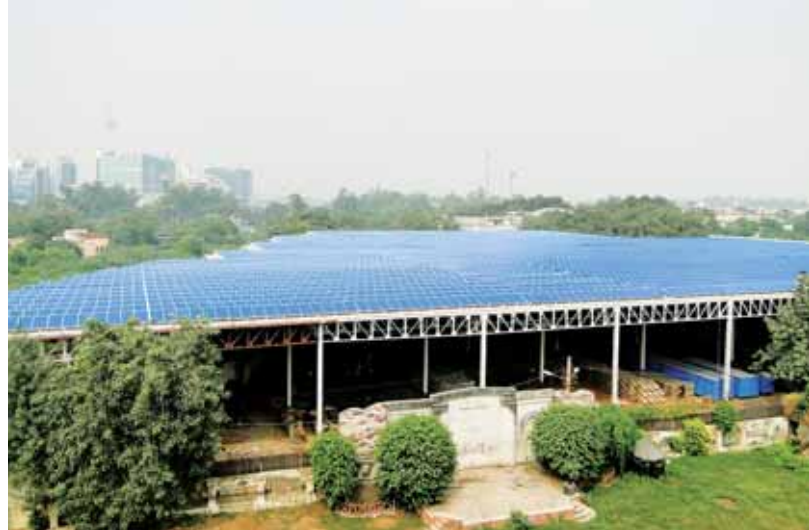
1 MW NDPL solar PV array
